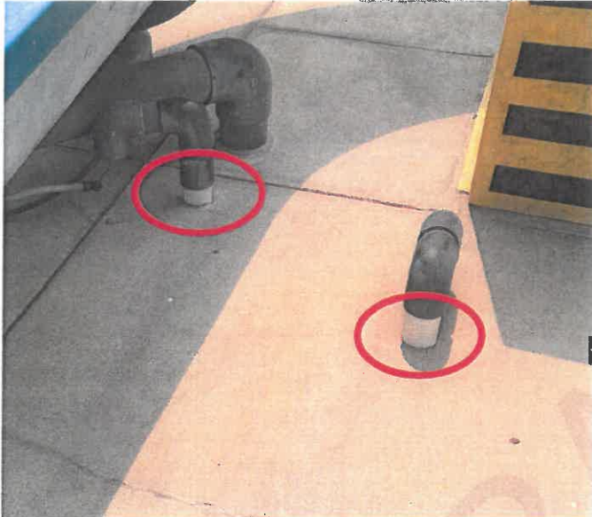
Loose Electrical Conduit
